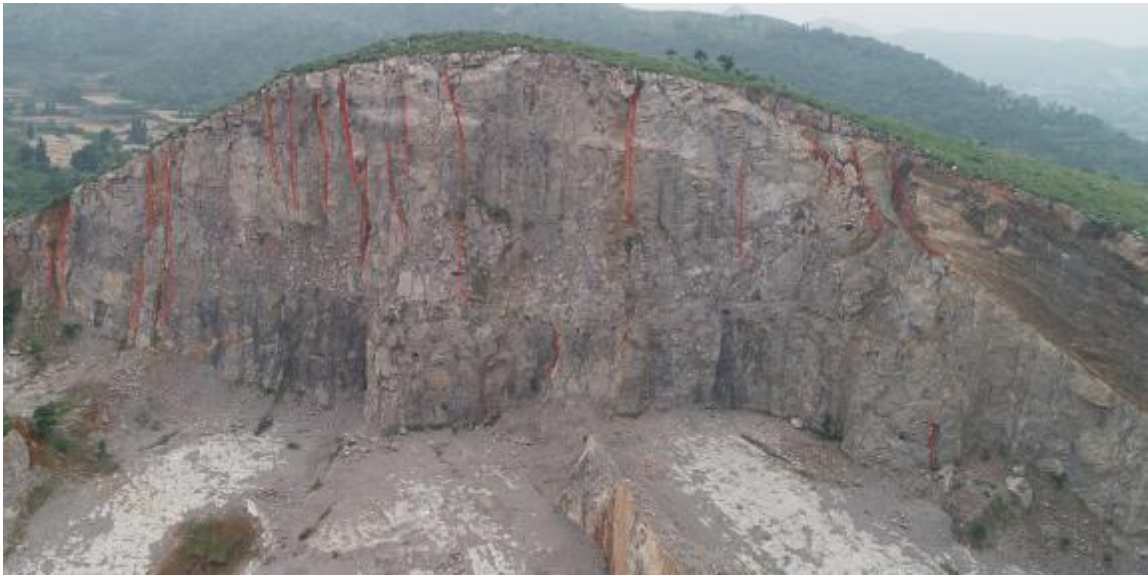
照片 3-7 治理区岩面裂隙现状照片 表 3-1 勘查区裂隙情况一览表
