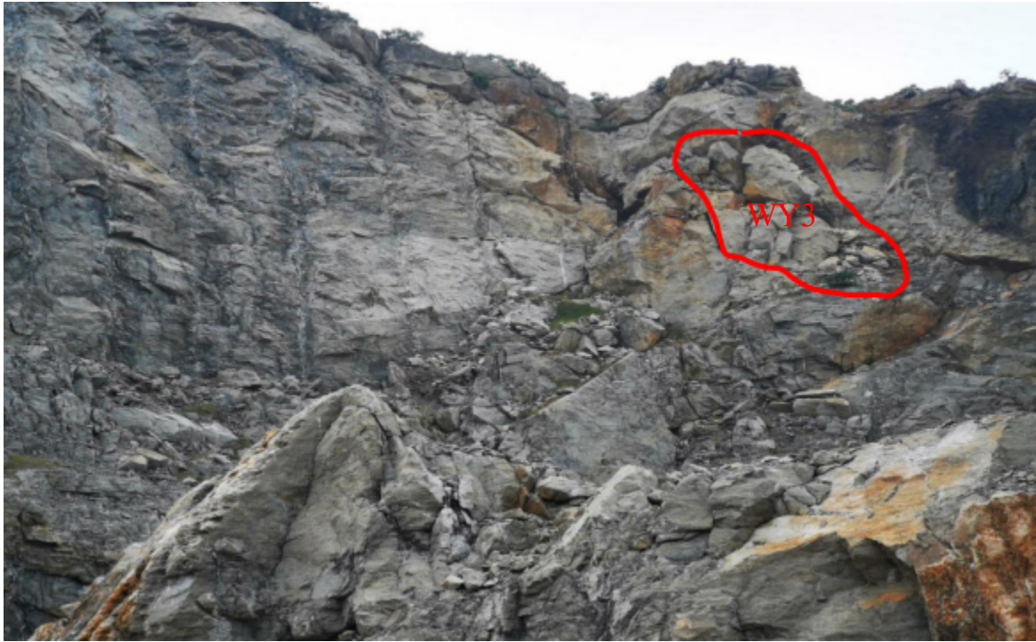
照片 3-5 治理区采坑危岩体现状照片
