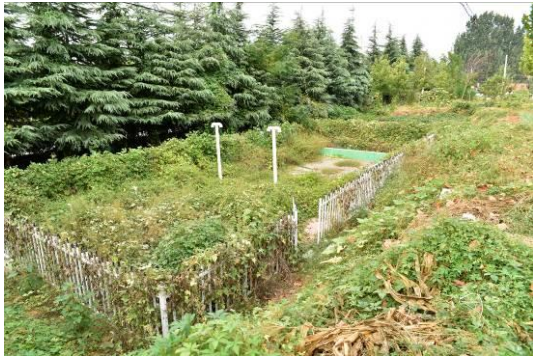
善固新村移民安置区污水处理系统
