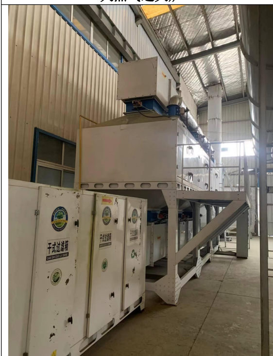
干式过滤+活性炭吸附脱附+燃烧
