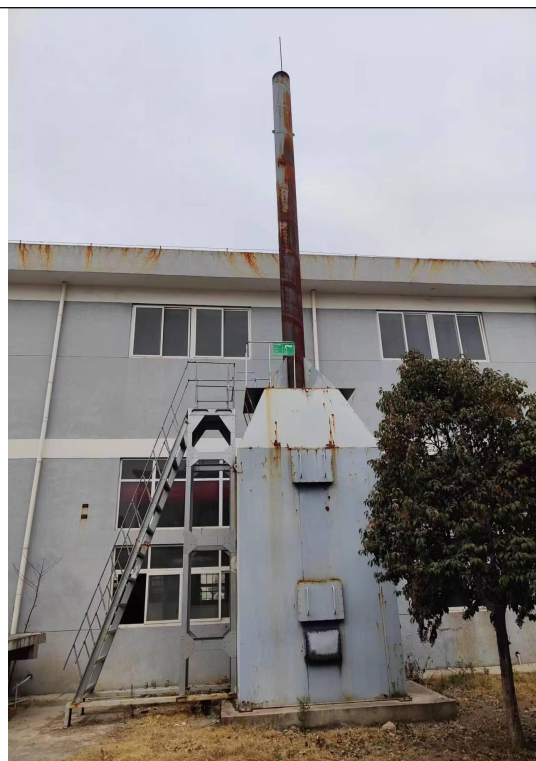
燃烧废气排气筒
