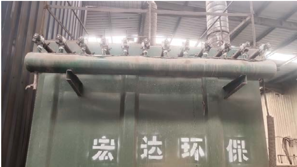
现有项目破碎等环节布袋除尘器
