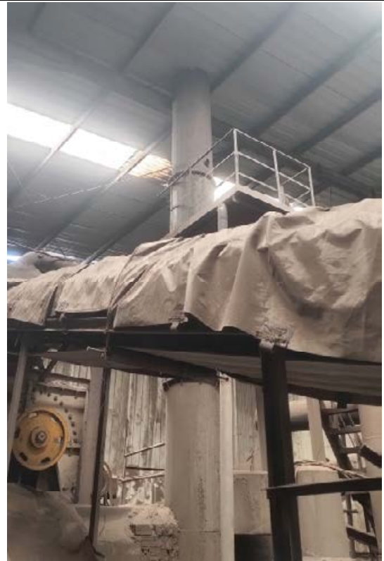
现有项目破碎等废气排气筒
