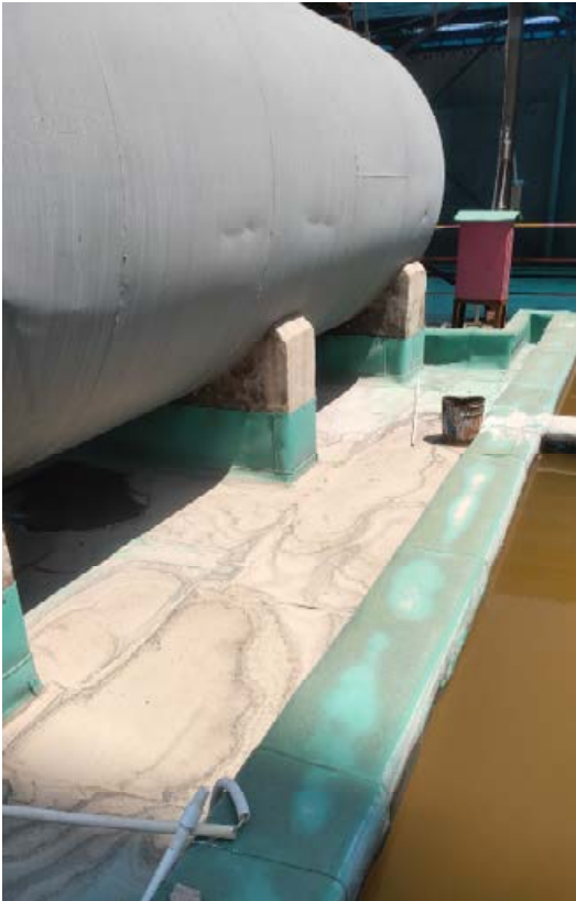
液碱储罐及罐区
