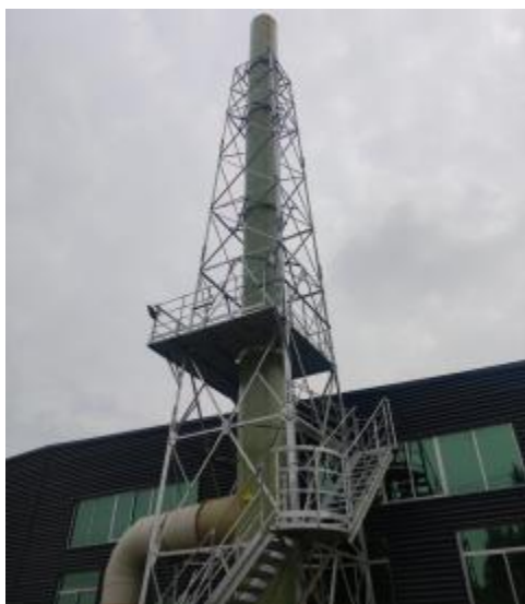
危废暂存库废气排气筒
