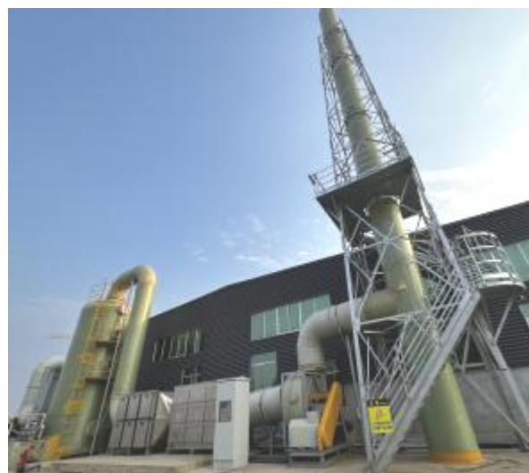
危废暂存库废气处理设施全景
