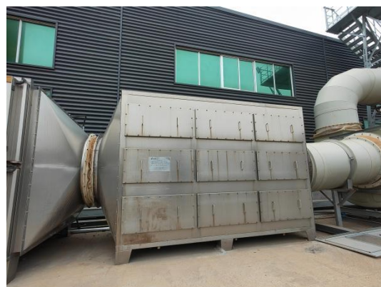
UV高效光解除臭设备、活性炭吸附箱
