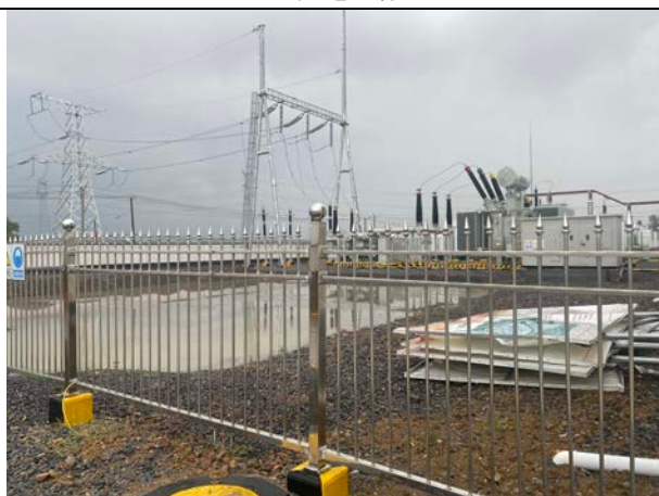
4. 2号主变及 GIS 预留位置
