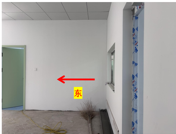
DSA 手术室东侧控制室
