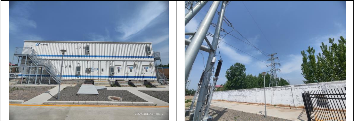
升压站现状照片
