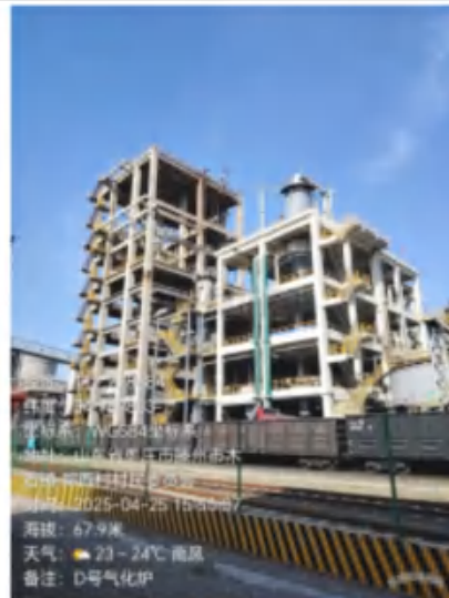
D#水煤浆气化炉
