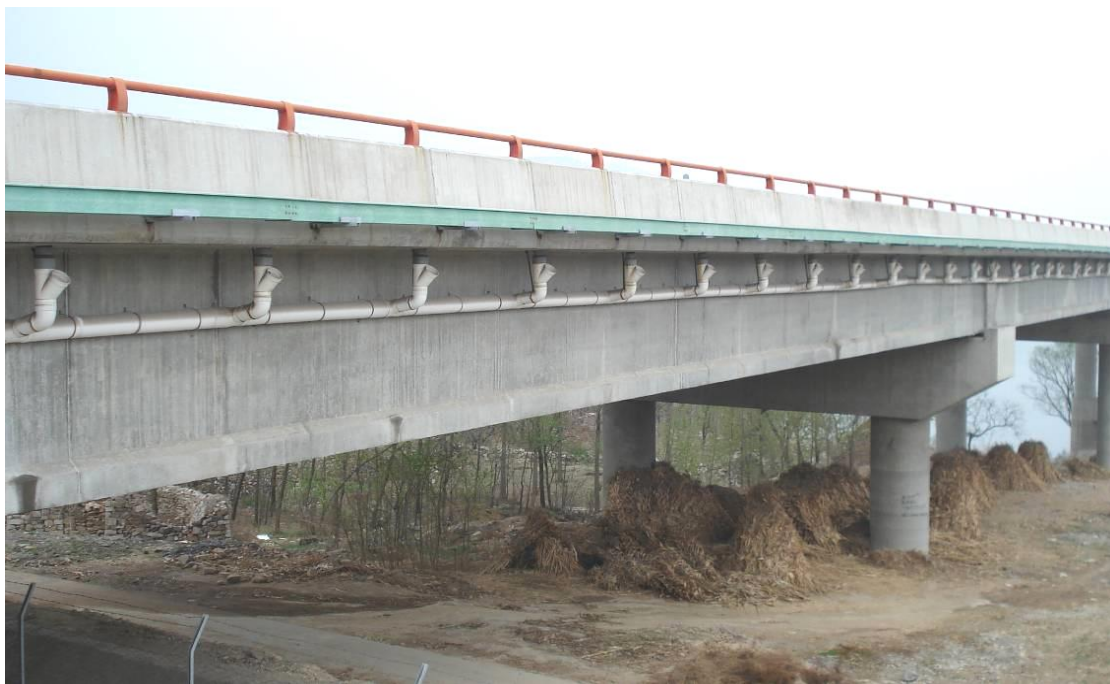
图 8.5-1 径流收集系统实景照片
