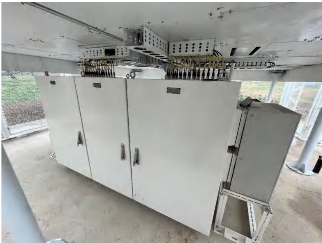
图 2.2-7 室外机柜实物图
