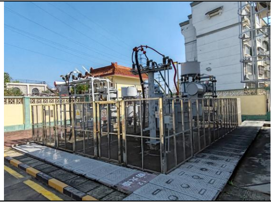
10kV 电容器、电抗器
