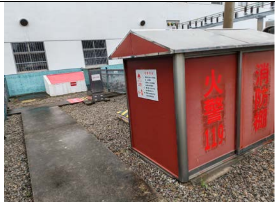
消防沙池、渗油池
