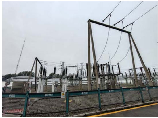
1 号主变配套设备区
