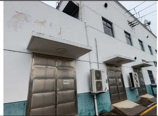
10kV 电容器室
