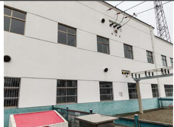
二层 35kV 电容器室
