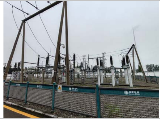
2 号主变配套设备区
