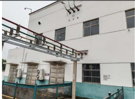
一层 10kV 电容器室
