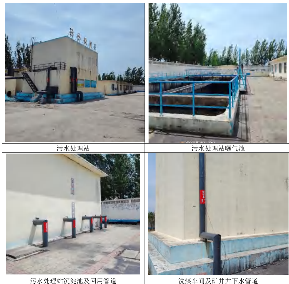
图2.3-6 废水治理设施
