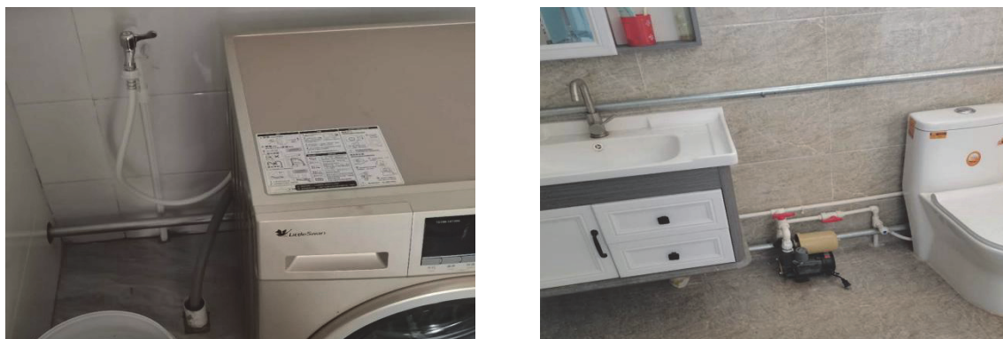
图 5-1 灰水收集点实景图
