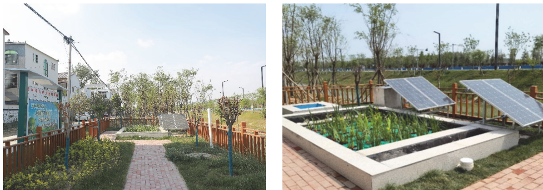
图 1-3 刘庄村微动力生化生活污水治理实景图
