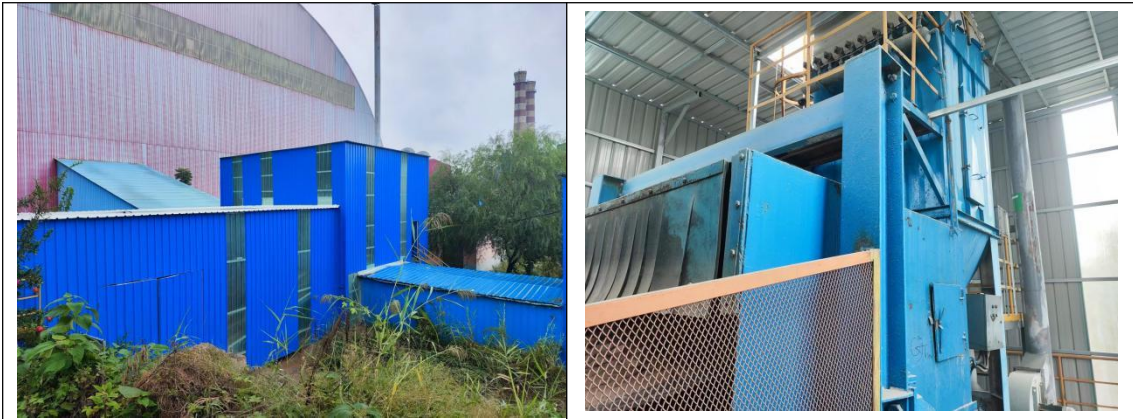
3#线破碎机平皮带转运站皮带转运站规范封闭
