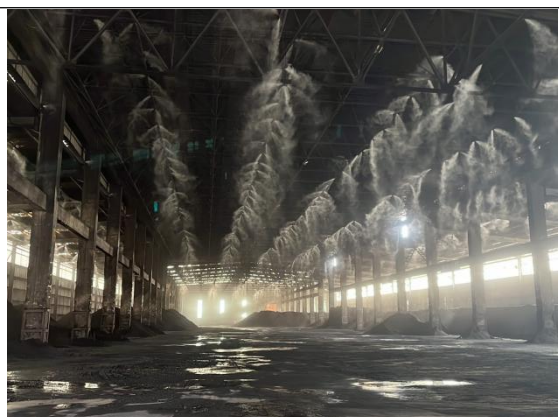
原煤堆棚内喷雾设施
