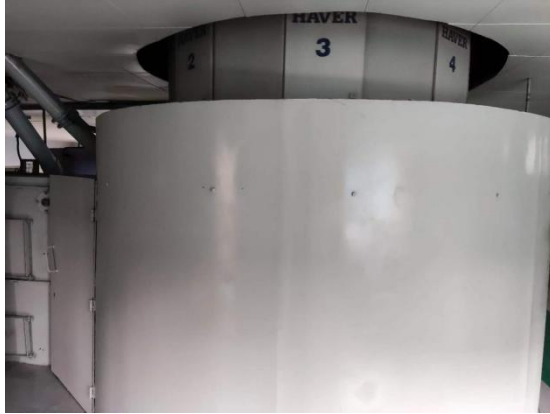
包装车间包装机封闭措施
