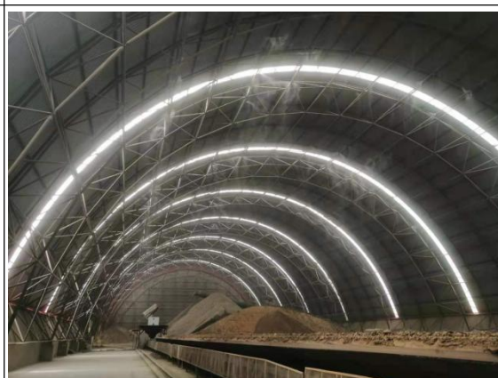
辅助原料预均化堆棚：已安装喷雾抑尘系统
