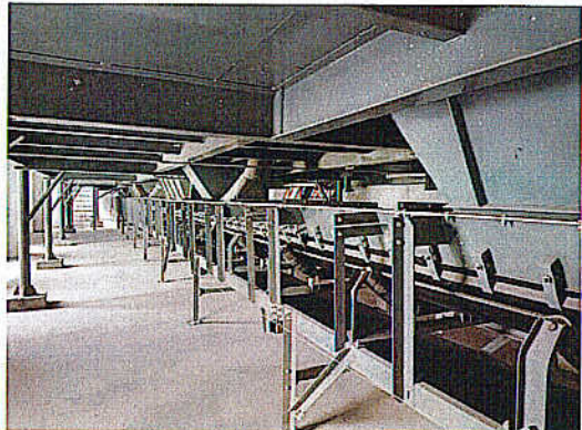
调配库底皮带封闭
