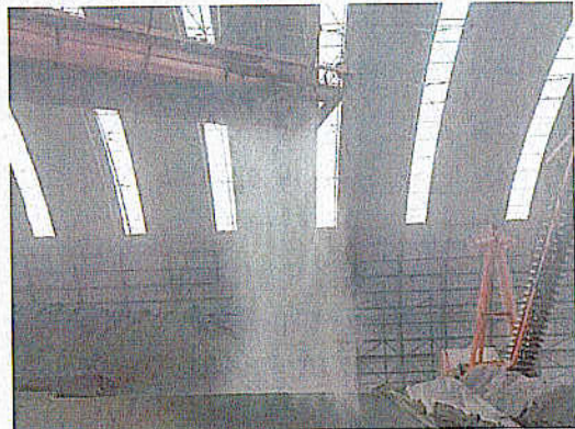
辅材均化棚悬臂堆料机下料口喷淋
