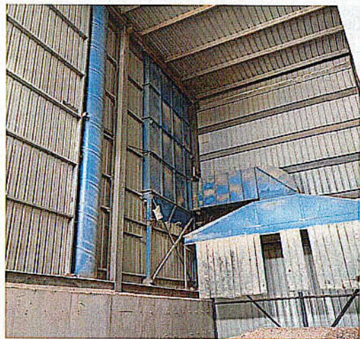
石灰石下料口设置在封闭料棚内
