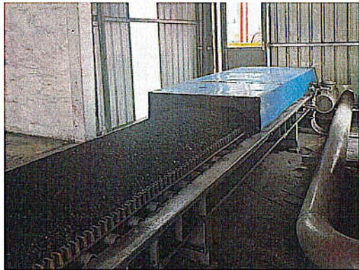
煤磨皮带机头封闭
