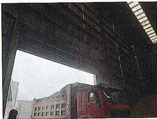
料棚门口干雾喷淋设施
