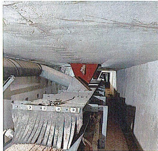
碎石下料受料皮带封闭及通廊
