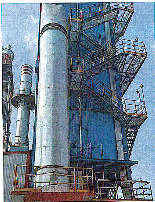
煤粉仓收尘器
