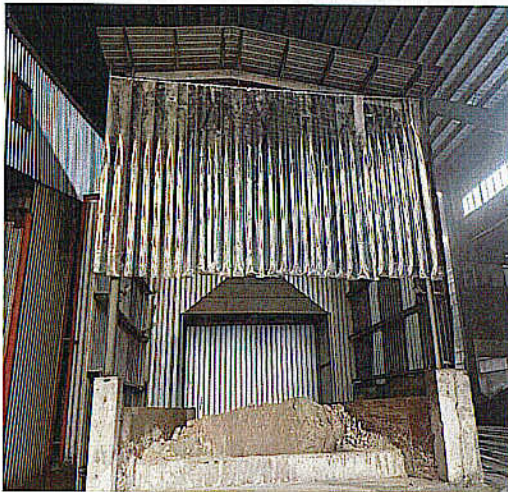
硅粉污泥下料口
