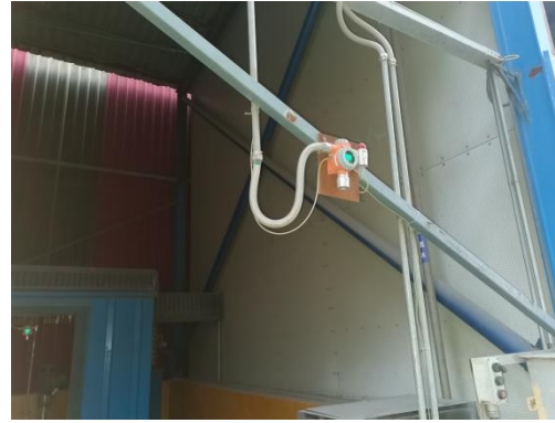
氨水罐区及泄漏检测装置
