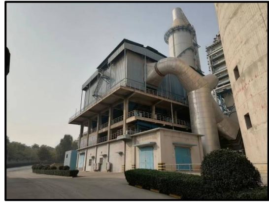
2#水泥窑窑尾脱销除尘
