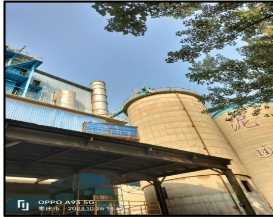
6#水泥磨除尘器
