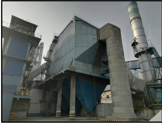
1#水泥窑窑头除尘器
