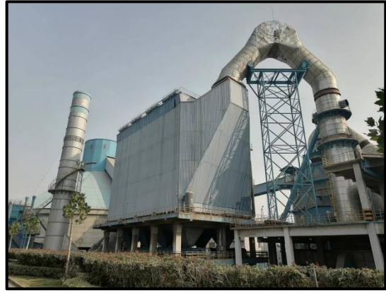
2#水泥窑窑头除尘器
