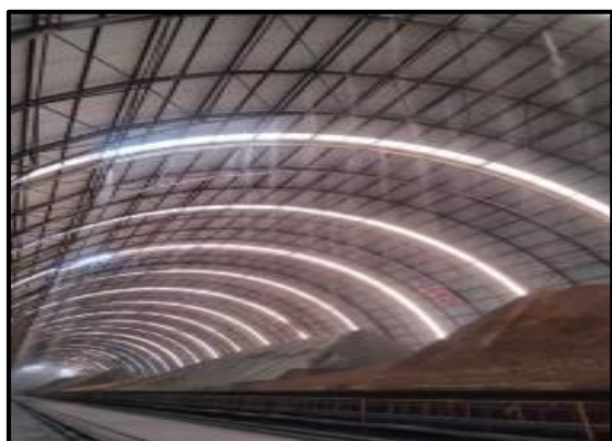
生料辅料棚天雾抑尘系统
