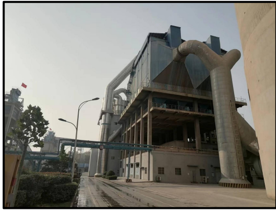
1#水泥窑窑尾脱销除尘
