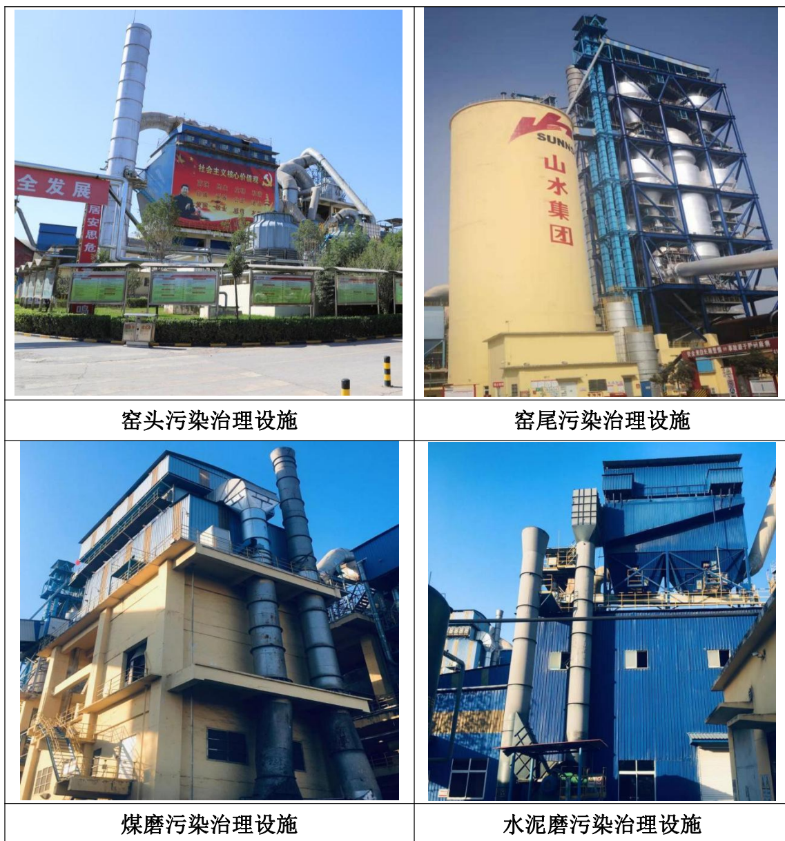
图 4 企业主要污染治理设施照片
