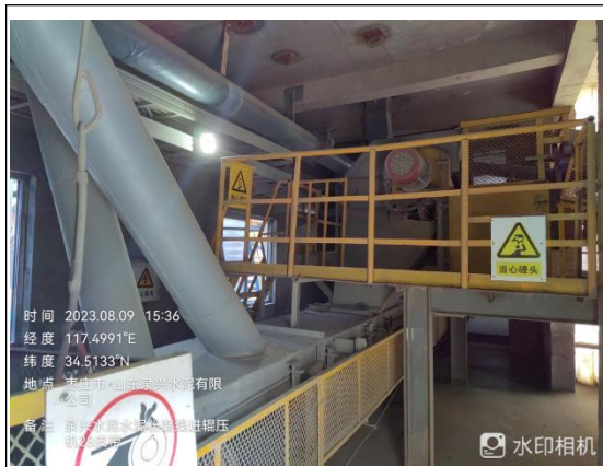
水泥调配库下料口设集气罩
