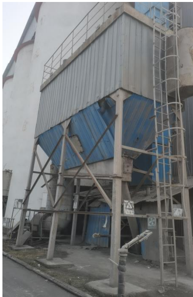
包装机除尘器
