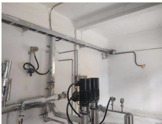
氨气泄漏报警装置
